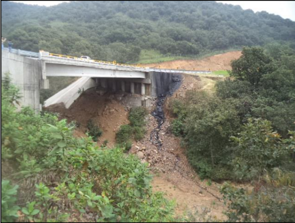
1.- Zona A del derrame de Combustóleo, se observa la afectación tanto en el talud de concreto del puente como en suelo natural del derecho de vía de la Autopista.
