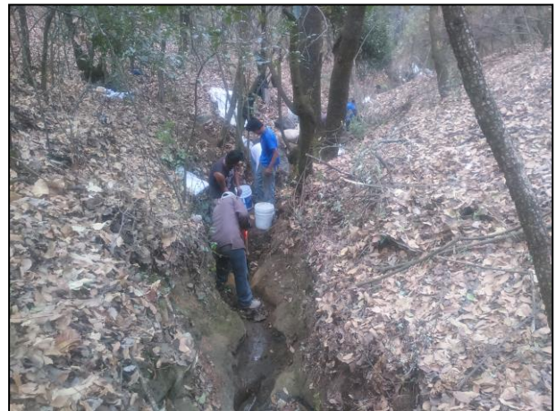
6.- Extracción del material edáfico afectado en la Zona C, zona accesible únicamente mediante recurso humano.
