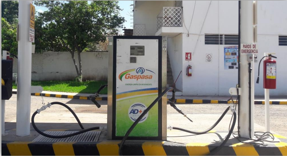
FIGURA 9: Área con dos suministros para el llenado de Gas L.P, ubicado en la Estación de servicios (carburación) “El Puente”.
