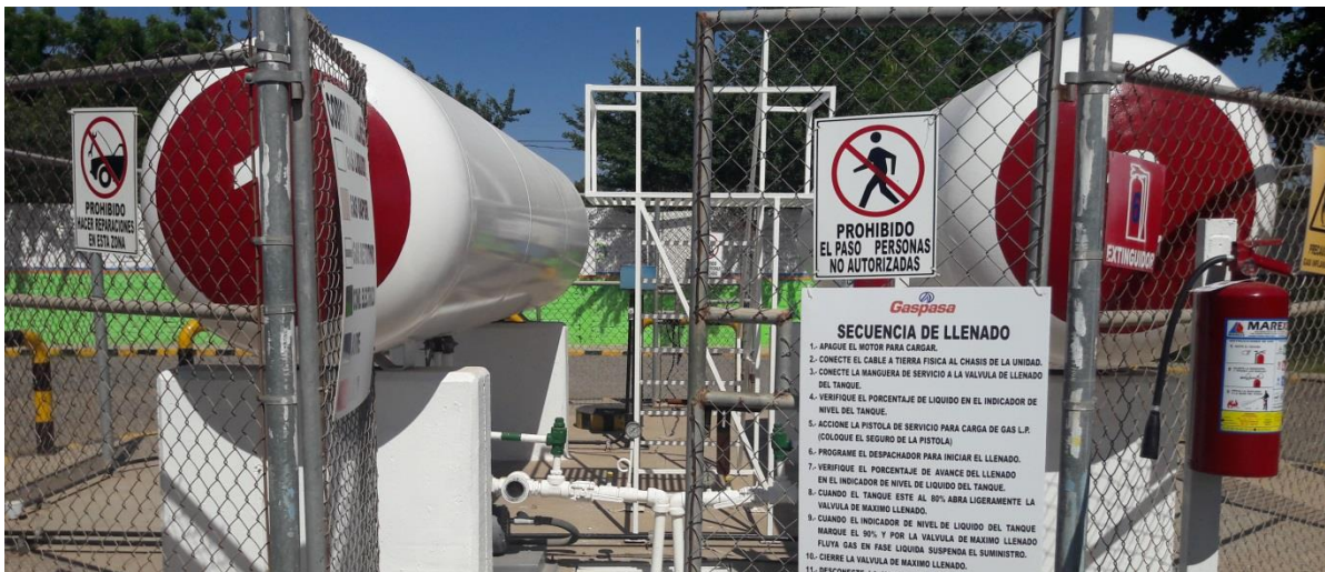
FIGURA 6: Equipos contra incendios (Extintores) y señalamientos preventivos ubicados dentro de la estación de servicio (carburación) “El Puente”
