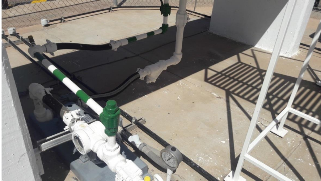
FIGURA 8: Bombas, ubicada dentro de la zona de protección de los tanques de almacenamiento, en la Estación de servicio (carburación) “El Puente”.
