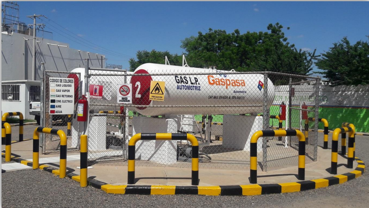
FIGURA 5. Tanques de almacenamiento de 5,000 L cada uno, ubicados en la estación de servicio “El Puente”
