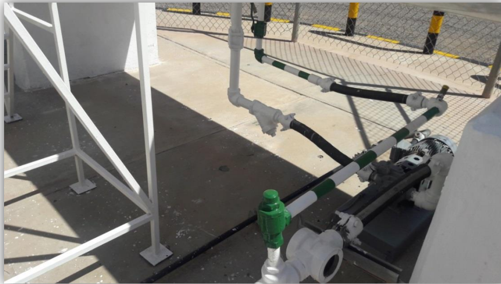
FIGURA 7: Tubería presente en las instalaciones de la Estación de servicio (carburación) “El Puente”
