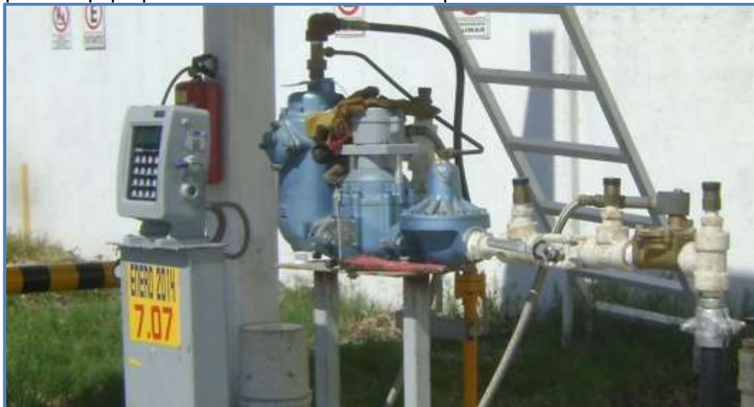
Figura II.2.5. Dispensario doble para el Gas L.P.
