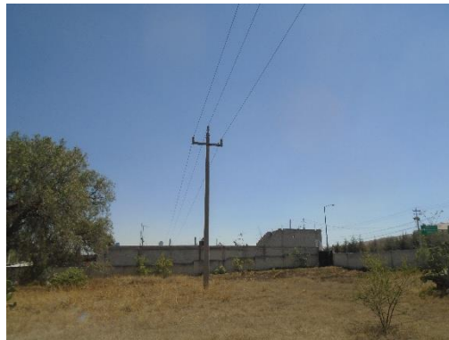
Fotografía II. 5. Red de energía eléctrica
