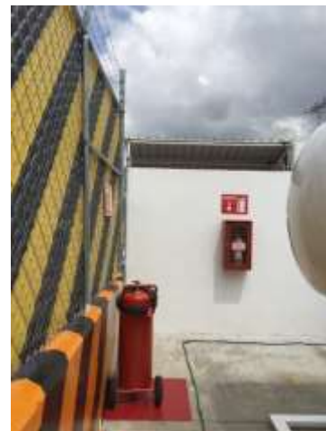
Sistema fijo para combate de contra incendio instalado en el área de tanque de almacenamiento
