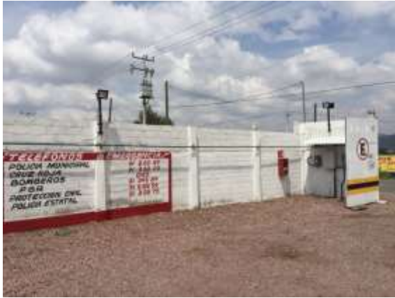
Iluminación y equipo fijo contra incendio instalado en el bardado perimetral del predio
