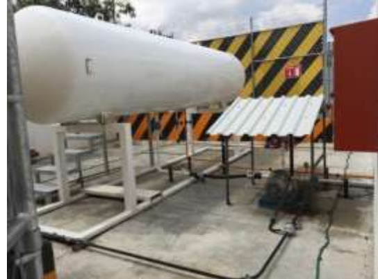
Tanque de almacenamiento de gas LP para carburación de 5 000 litros de capacidad
