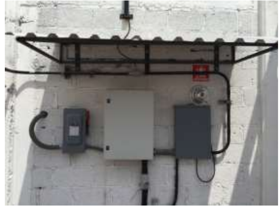
Alarma de emergencia instalada en la estación de gas LP para carburación
