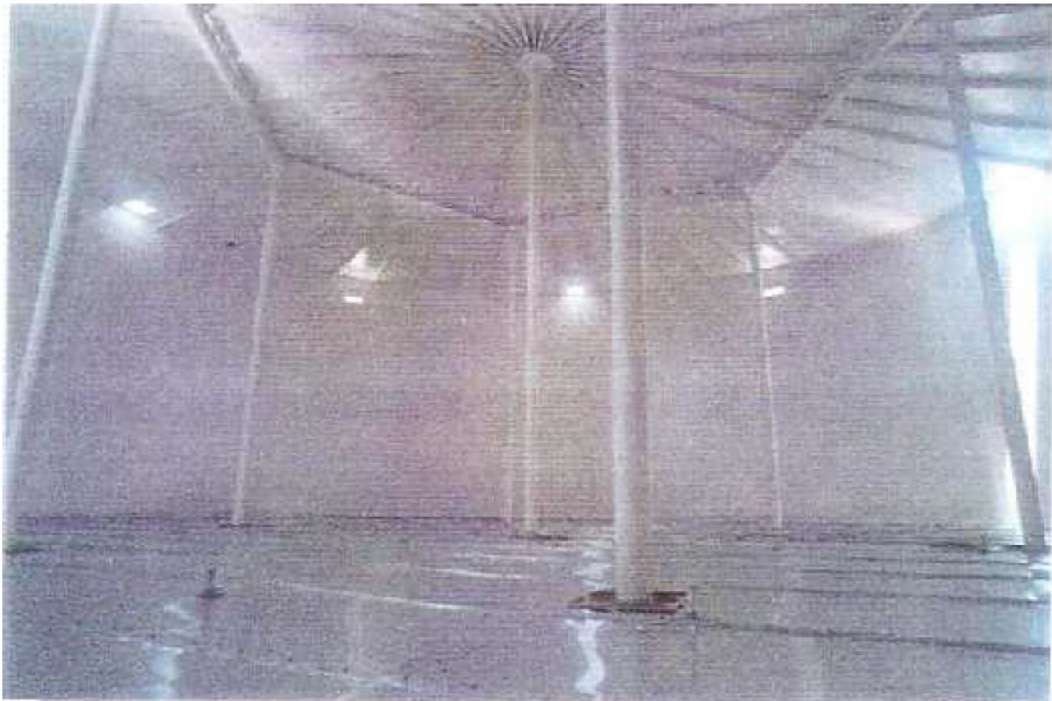
VISTA SUPERIOR DE LA MEMBRANA FLOTANTE INTERNA
