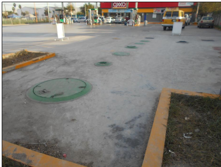
Imagen 2. Área de tanques de almacenamiento en estación de servicio.
