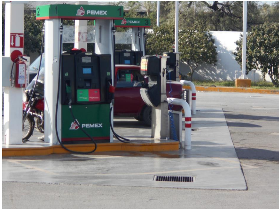
Figura 2. Dispensarios de la estación de servicio.
