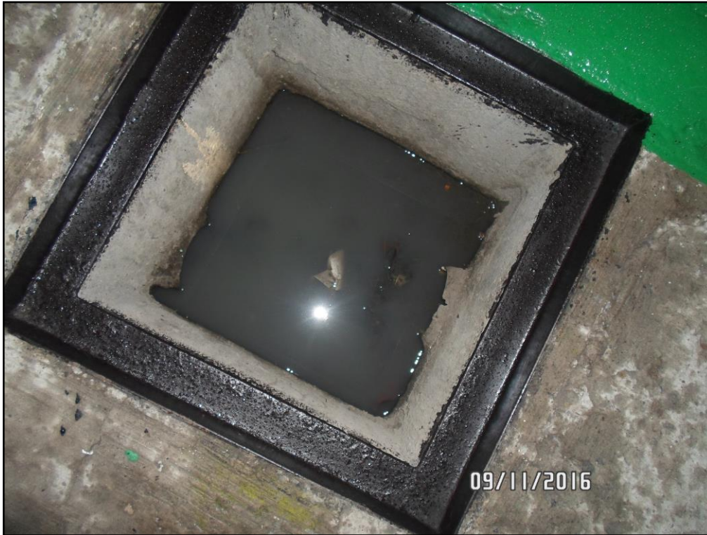
Imagen 1. Trampa de aceites de la estación de servicio.
