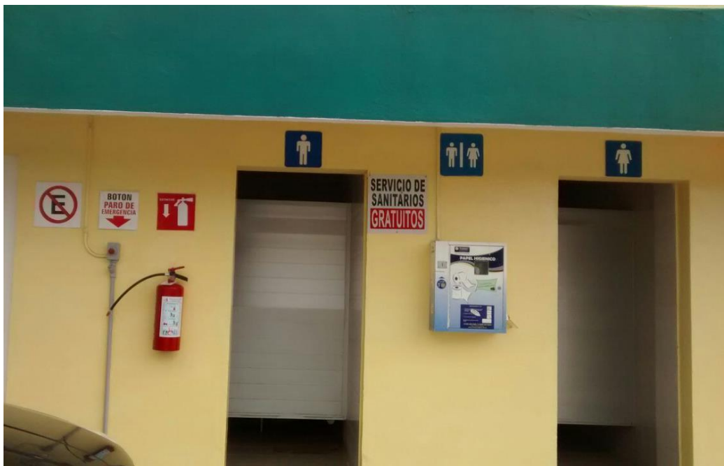
Fotografía 3. Extintor y paro de emergencia en la zona oficina y sanitarios.
