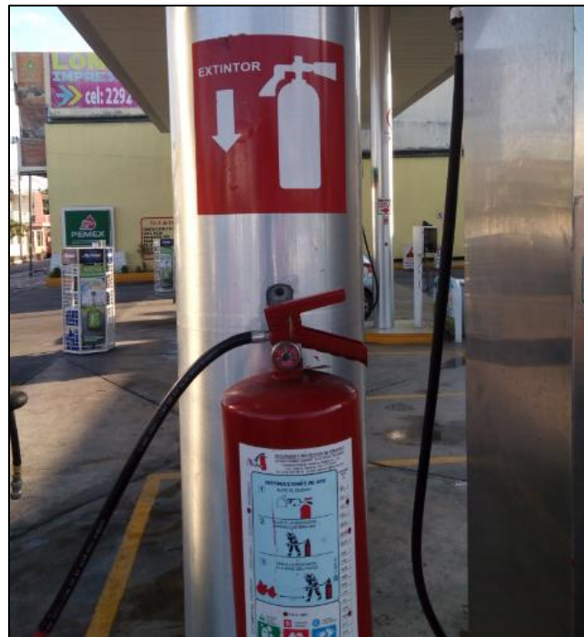
Fotografía 4. Equipo contra incendio en área de despacho.
