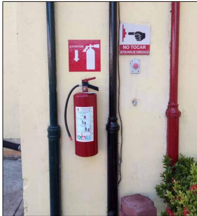
Fotografía 5. Equipo contra incendio en área de venteos.
