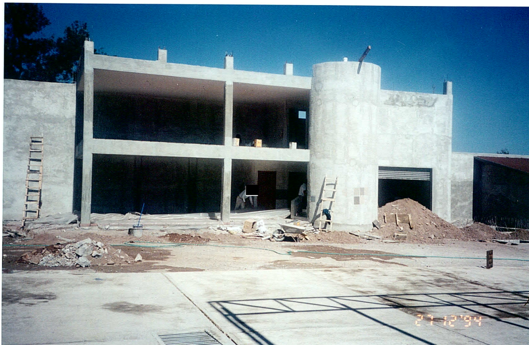
Imágenes 7 y 8: Etapa de obra previo al inicio de operaciones el 10 de enero de 1995. Oficinas Generales e Islas de despacho de diesel. fuente: Distribuidora Del Sur de Salamanca S.A. de C.V.
