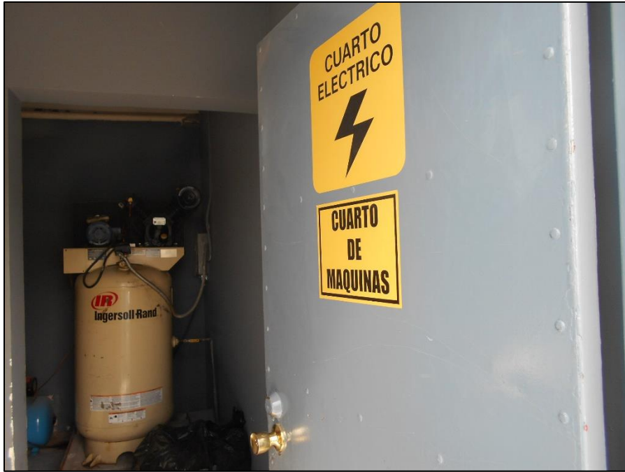
Imagen 1. Cuarto eléctrico, cuarto de máquinas.
