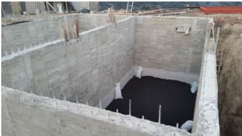
Figura 23. Fosa de los tanques de almacenamiento.
