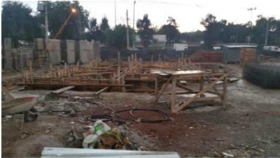
Figura 25. Área de Tanques de almacenamiento.
