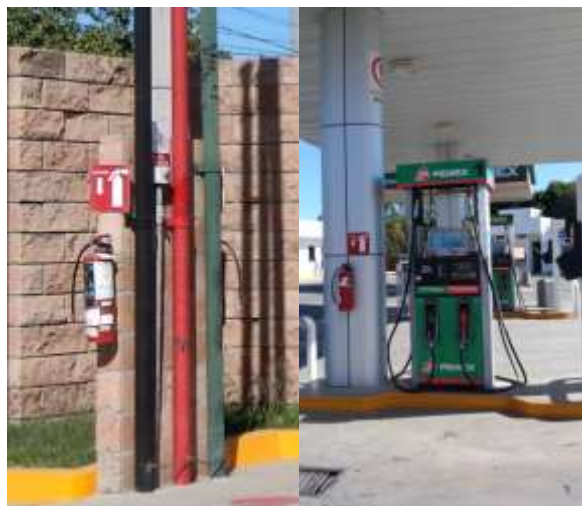
Figura 20. De acuerdo a los lineamientos de seguridad se cuenta con extintores en diferentes puntos estratégicos y a la vista de todos, estos a su vez se encuentran a no más de 15 metros de cada área Ej. Dispensarios y Sist de Venteo.
