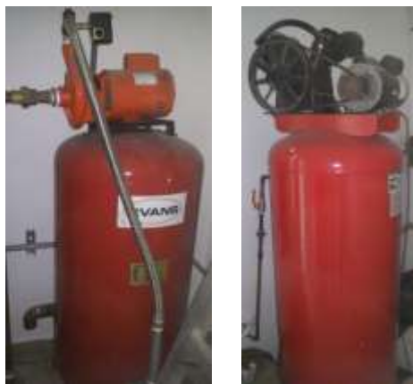
Figura 18. Área de máquinas, compresores.
