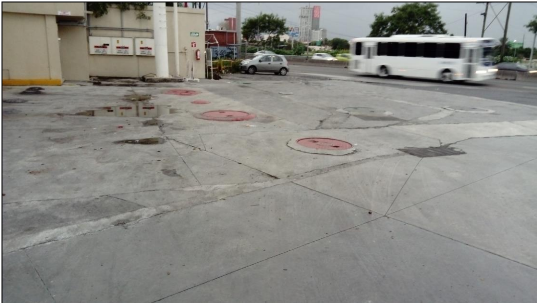
Figura 3. Área de tanques de almacenamiento.
