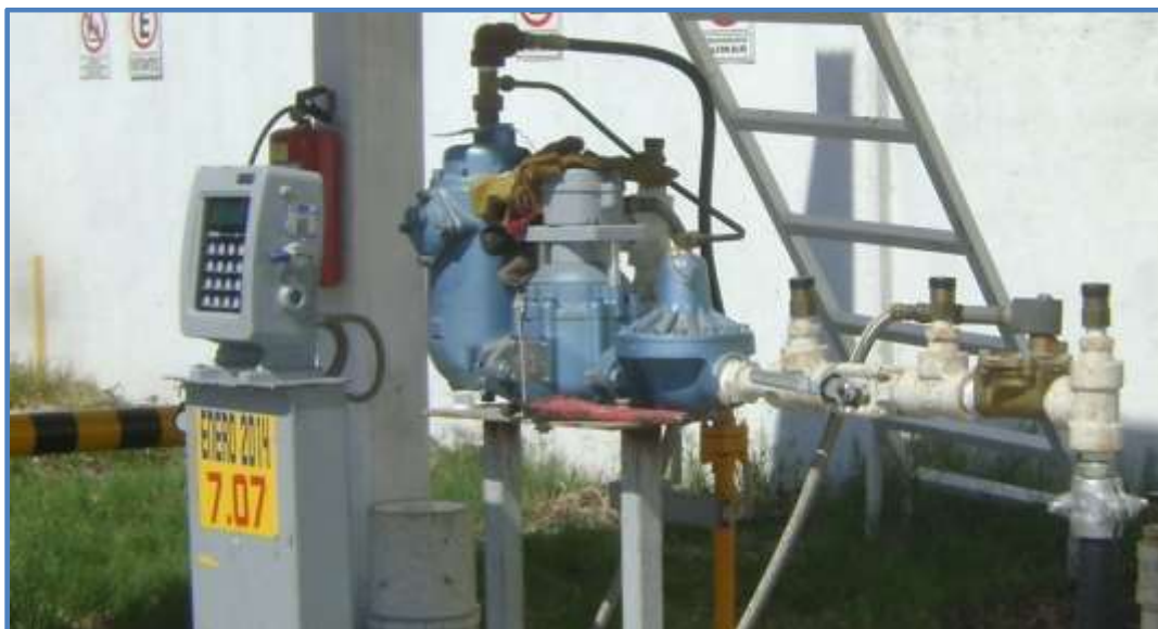
Figura III.1.c)-1. Dispensario doble para el Gas L.P.
