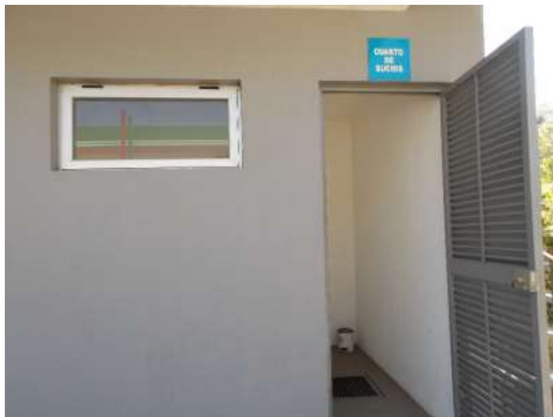
Figura 7. Cuarto de sucios destinado como almacén temporal de residuos. Fuente: SAP Servicios Ambientales Profesionales
