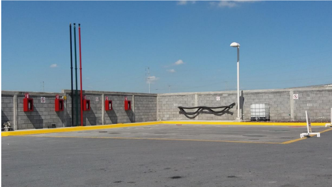
Vista de las quemadores de gases en el límite Oeste del área del proyecto.
