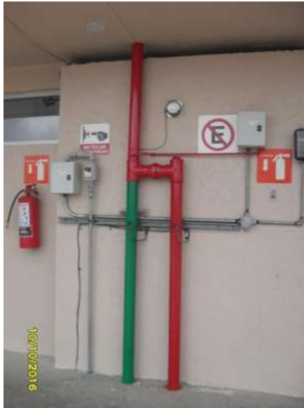
Fotografía 16.- Se observa señalamientos de seguridad y extintor y paro de emergencia.
