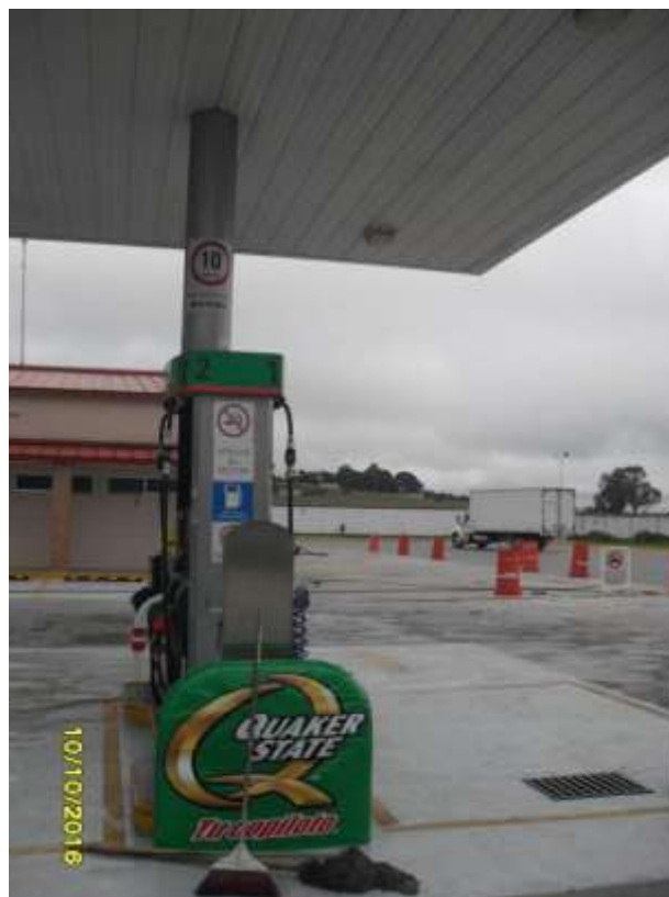
Fotografía 15.- Se observa señalamientos de seguridad y extintor en cada dispensario.
