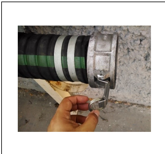
Vista lateral de manguera de descarga de Combustibles
