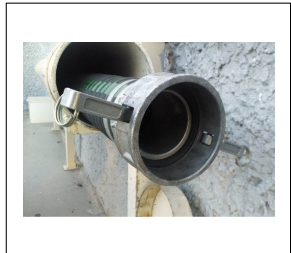
Vista de manguera de descarga de Combustibles, se observan los cinchos de sujeción.
