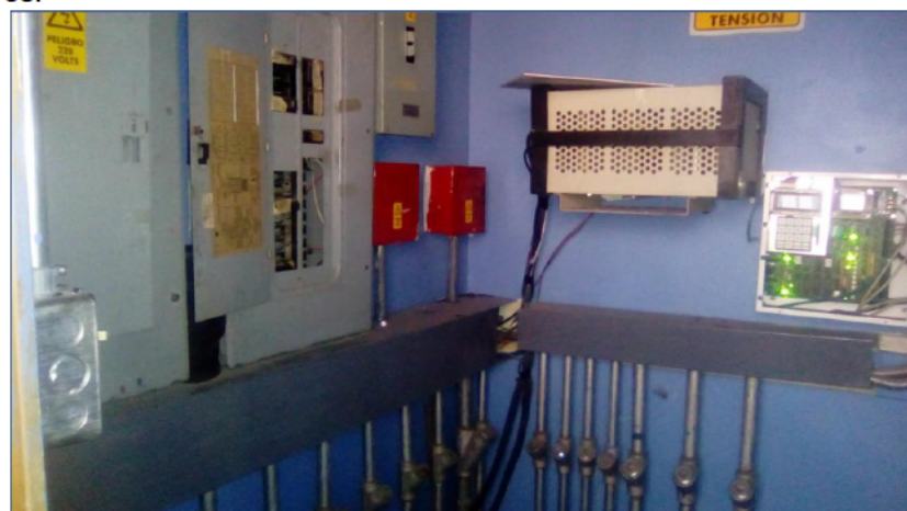
Foto 5. Cuarto de Controles Automatizados.
