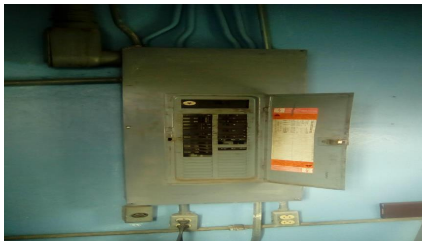
Foto 5. Cuarto de Controles Automatizados.
