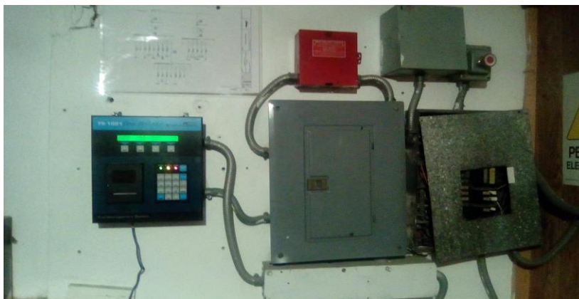
Foto 5. Cuarto de Controles Automatizados.
