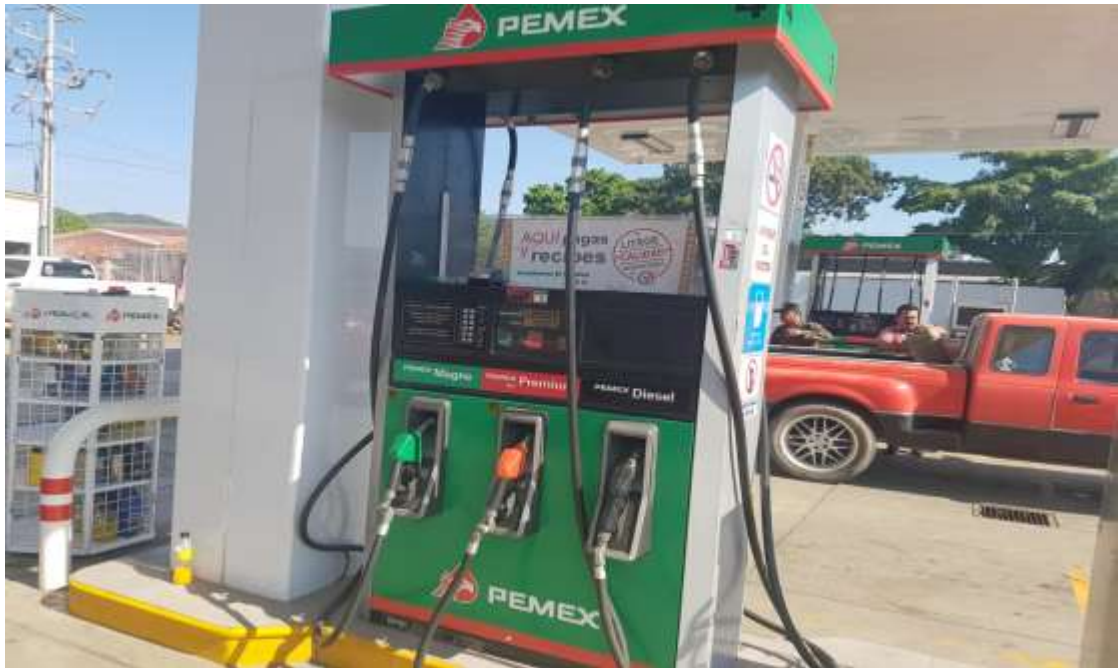
Fotografía 7.- Módulos de despacho de gasolina
