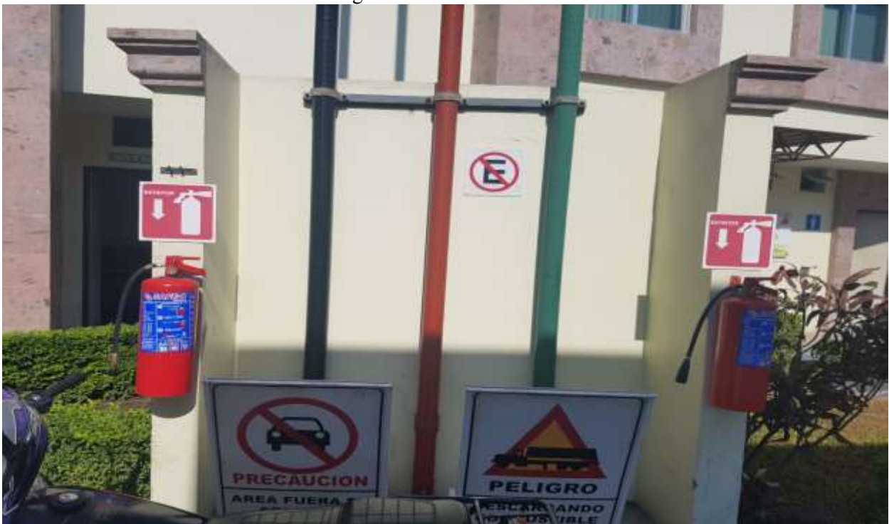
Fotografía 9.- Cuarto de Maquinas
