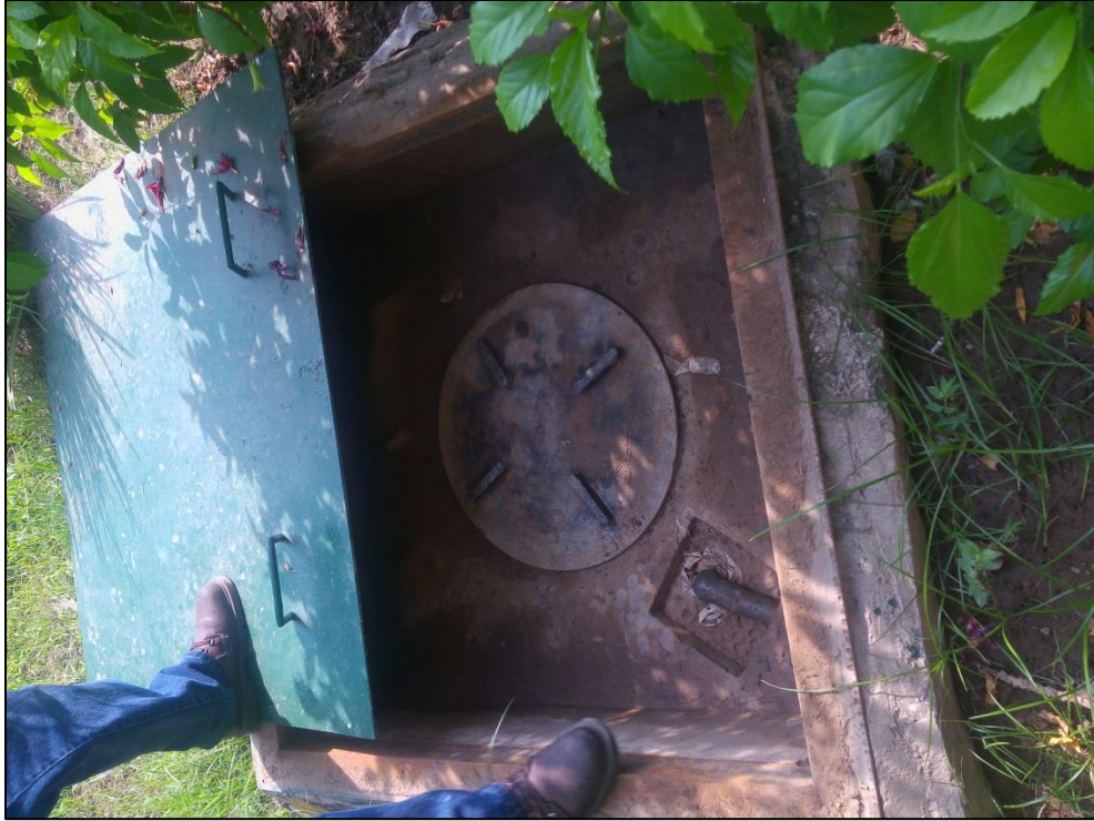
Fotografía 8. Trampa de grasas.
