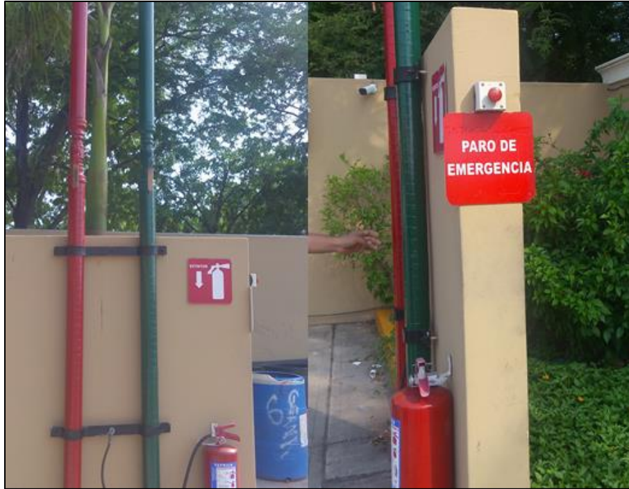
Fotografía 6. Zona de Venteos y sus sistemas de seguridad.
