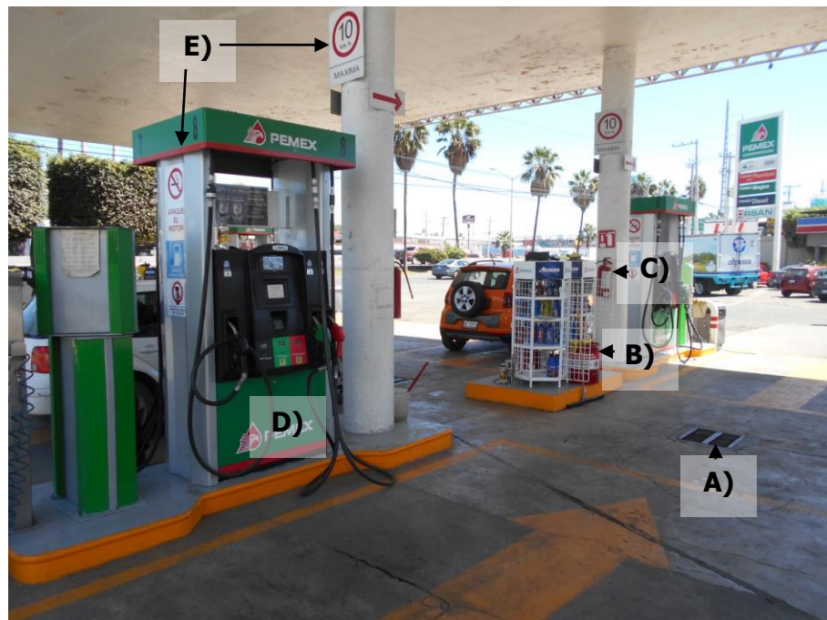
Imagen 4. Área de dispensarios. Se aprecia A) rejilla del sistema de drenaje aceitoso, B) contenedor de residuos peligrosos, C) sistema contra incendio basado en extintores, D) dispensarios de combustibles, y E) señalización de seguridad.
