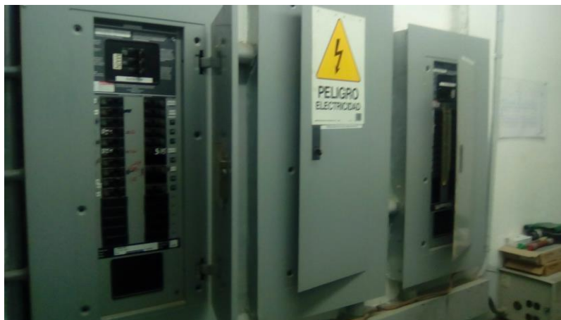
Foto 5. Cuarto de Controles Automatizados.
