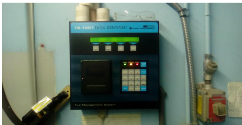
Foto 5. Cuarto de Controles Automatizados.
