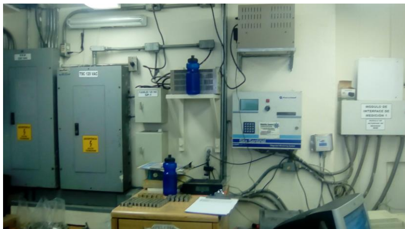
Foto 5. Cuarto de Controles Automatizados.
