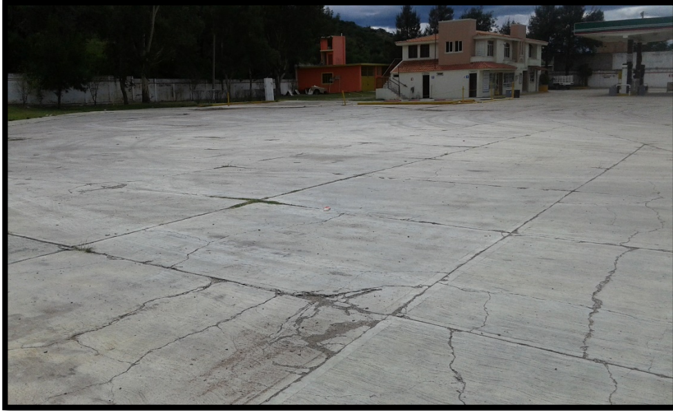
Condición actual de los pisos en la zona de circulación y maniobras. Agrietado debido al uso.
