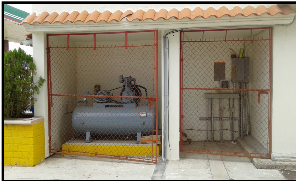
Área de Máquinas
