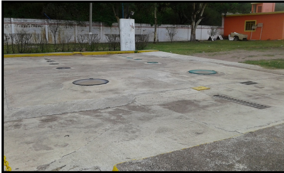
Área de tanques. Capacidad de 60 000 lts para ambos tanques
