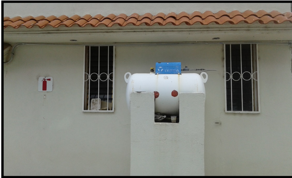
Tanque de Gas de la Estación.
