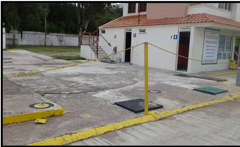
Área de Tanques. Para Diésel y Gasolina Magna, con una capacidad de 50 000 lts cada uno.
