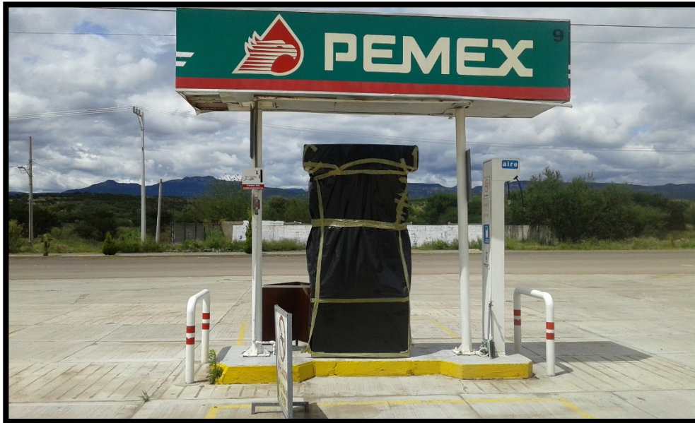
Dispensario de Combustible Diésel. Cubierto con naylon para evitar su deterioro
