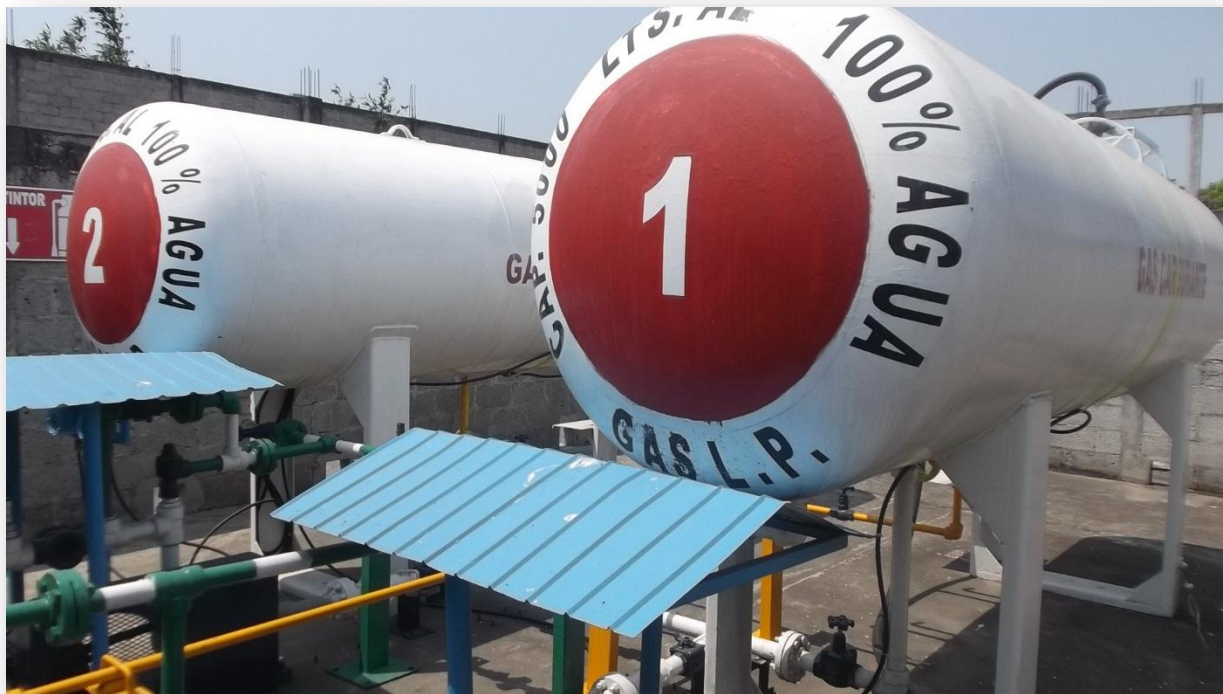
Tanques de almacenamiento Estación de Carburación Tejería
