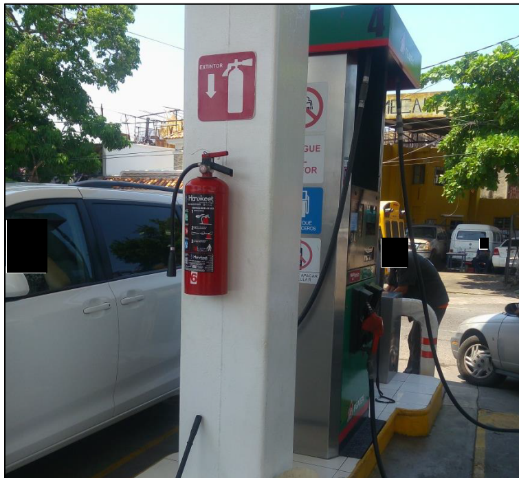
Fotografía 2. Equipo contra incendios en el área de despacho.
