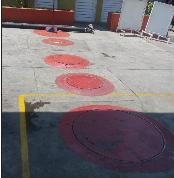
Fotografía 5. Zona de tanques de almacenamiento de gasolina Premium.
