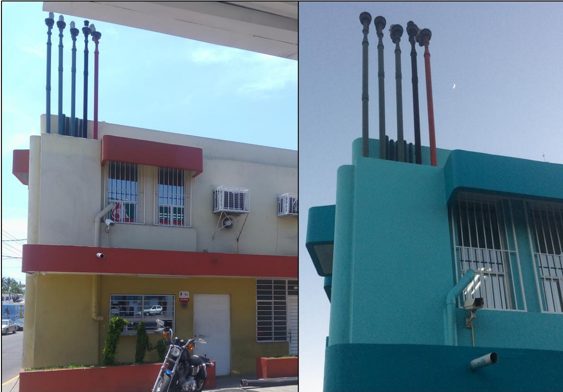
Fotografía 7. Zona de venteo.
