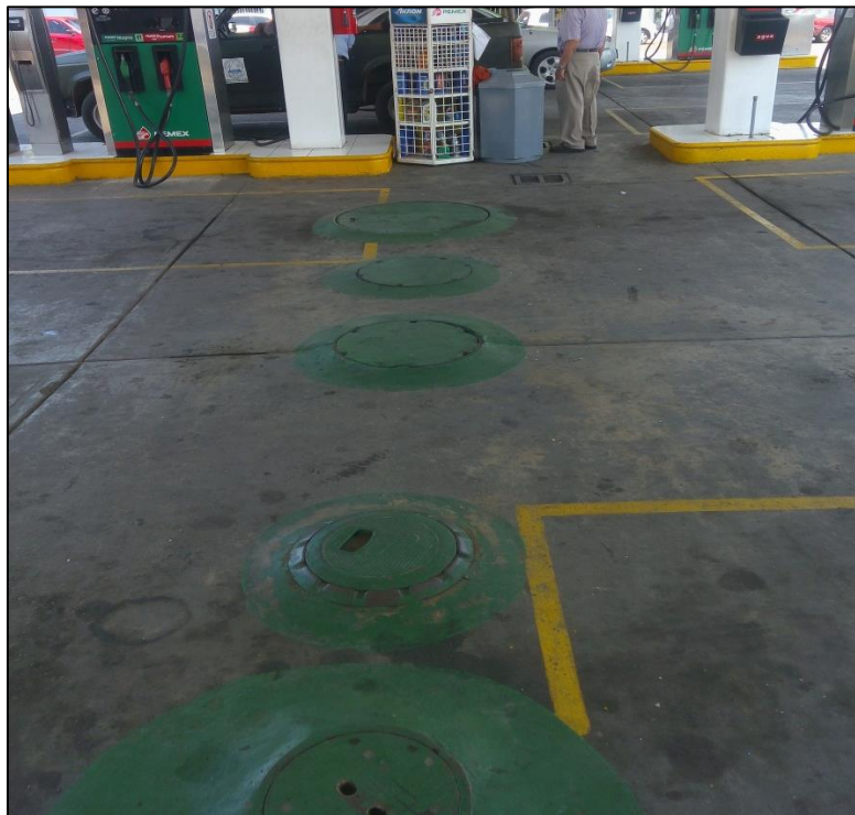
Fotografía 4. Zona de tanques de almacenamiento de gasolina magna.
