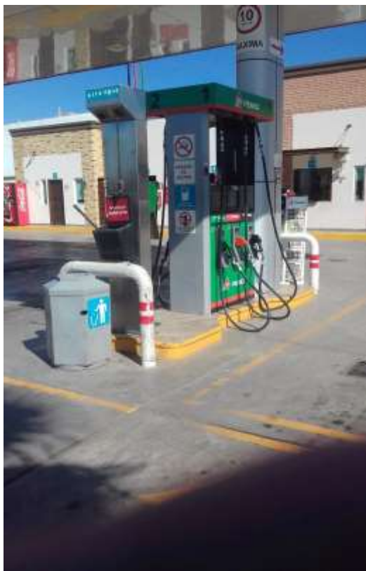
Fotografía 3. Área de despacho y señalizaciones de seguridad.
