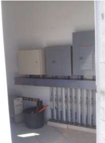
Figura 15. Evidencia fotográfica del área de control eléctrico.
