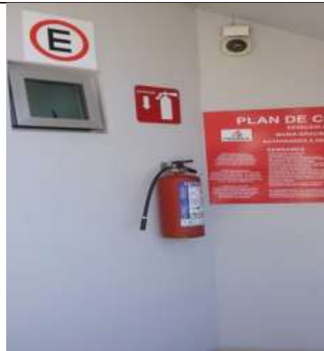
Figura 18. En cumplimiento a él plan preventivo de accidentes y contra incendios se muestra evidencia fotográfica de instalación de extintores y señalamientos vistosos para su identificación de manera rápida.
