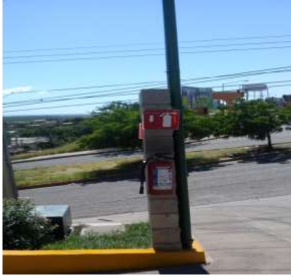
Figura 19. De acuerdo a los lineamientos de seguridad se cuenta con extintores en diferentes puntos estratégicos y a la vista de todos, estos a su vez se encuentran a no más de 15 metros de cada área de trabajo.
