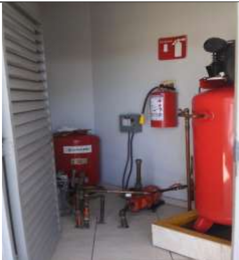
Figura 17. Área de máquinas, compresores, extintores.
