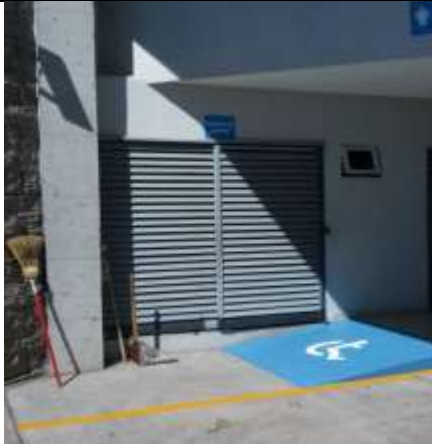
Figura13. Evidencia fotográfica de la bodega de limpios, se puede observar el cumplimiento con las adecuaciones para personas discapacitadas y las delimitaciones con franjas amarillas de seguridad de acuerdo a lo estipulado para estaciones de servicio de PEMEX.
