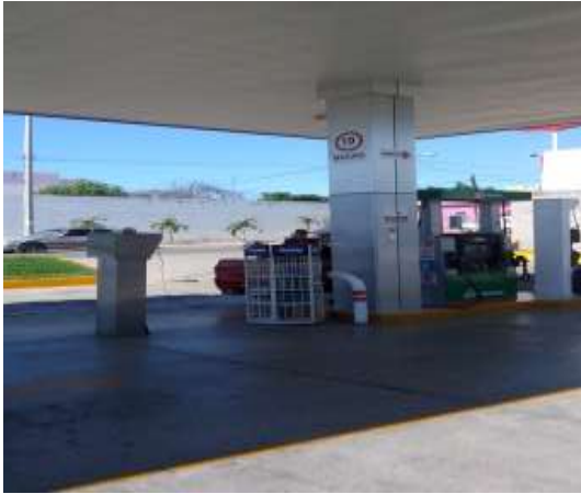
Figura 21. Vista fotográfica de los despachadores de gasolina, que cuentan con señalamientos de seguridad, techumbre adecuada, franjas amarillas con las dimensiones adecuadas.
