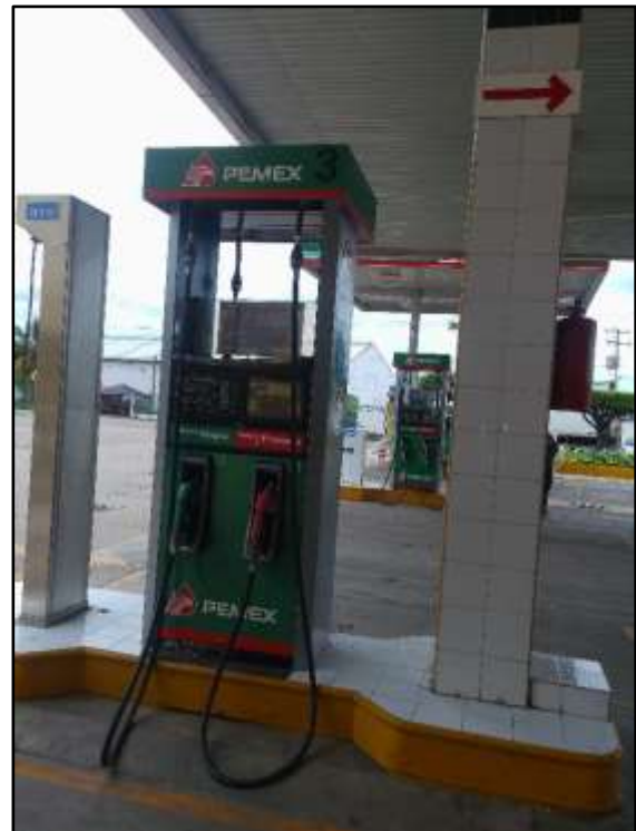
Fotografía 6.- Módulo de despacho de gasolina
