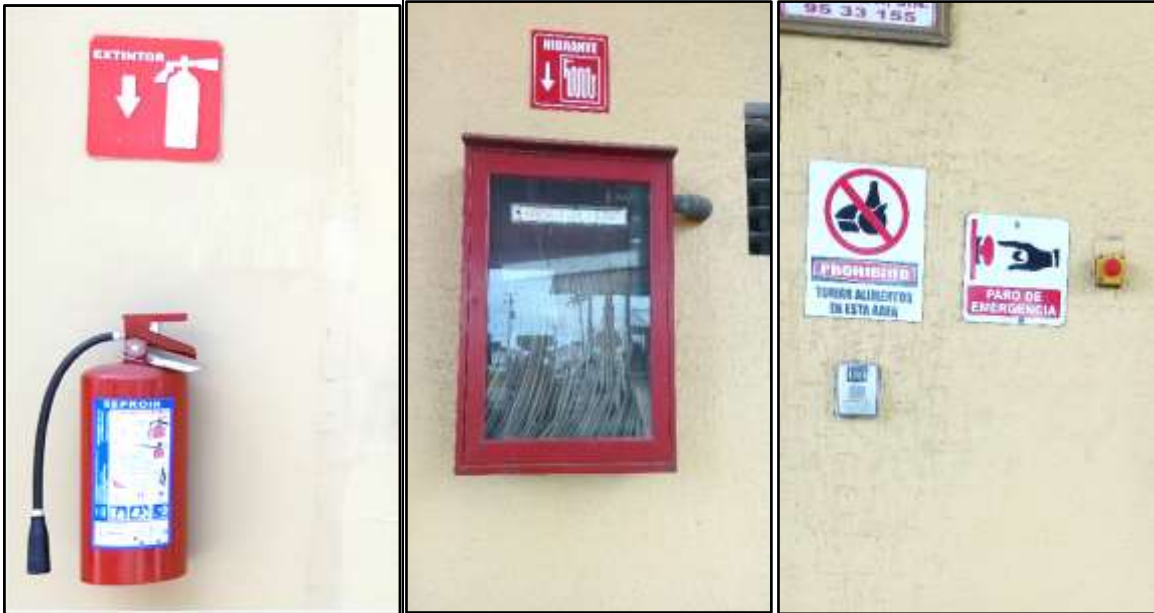
Fotografía 7, 8 y 9.- Medidas de Seguridad en la Estación de Servicio.
