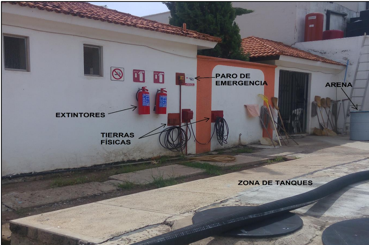
Fotografía 8.- Medidas de Seguridad en la Zona de Tanques de Diésel.
