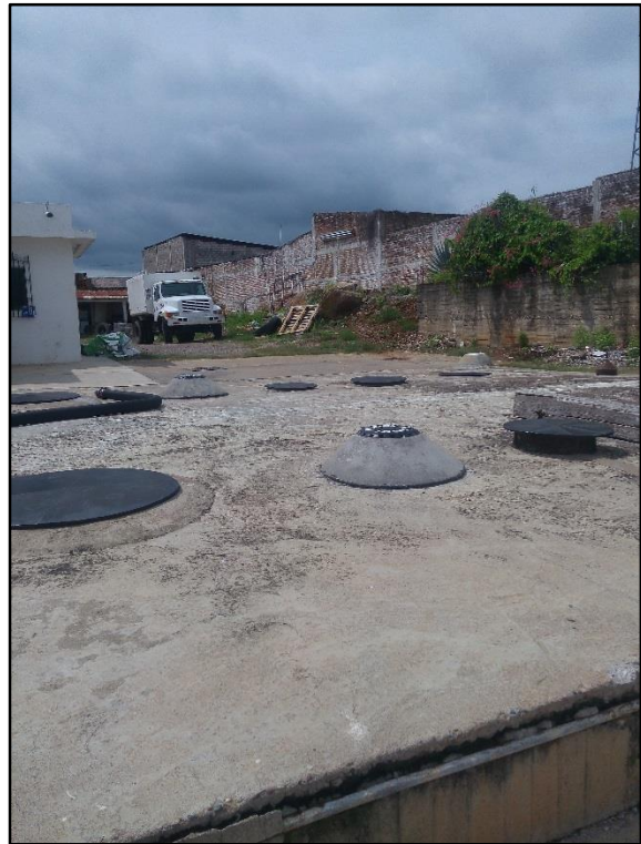
Fotografía 5.- Vista de la zona de tanques.
