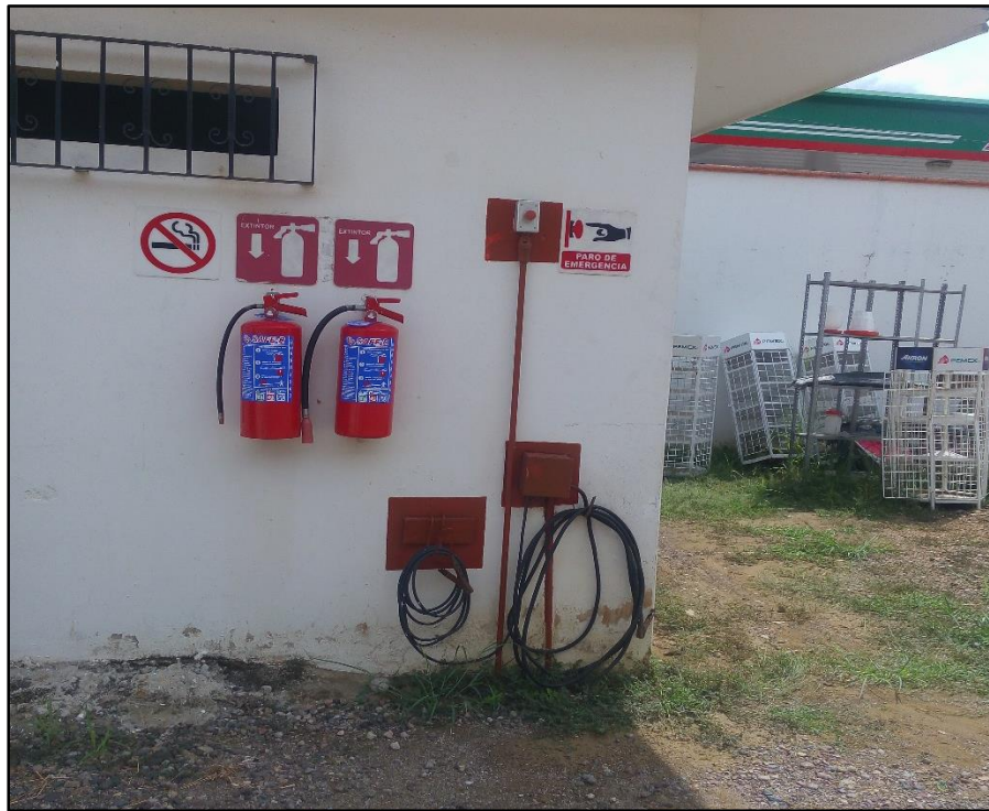
Fotografía 9.- Medidas de Seguridad en la Zona de Tanques de Gasolina.
