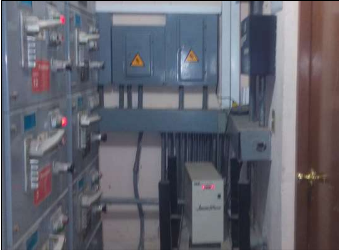
Fotografía 9. Cuarto eléctrico y de máquinas.
