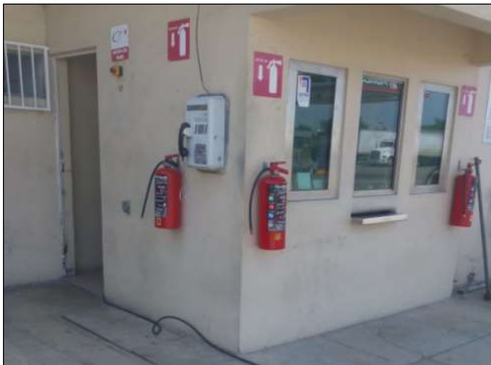
Fotografía 4. Equipo contra incendios en oficinas administrativas.
