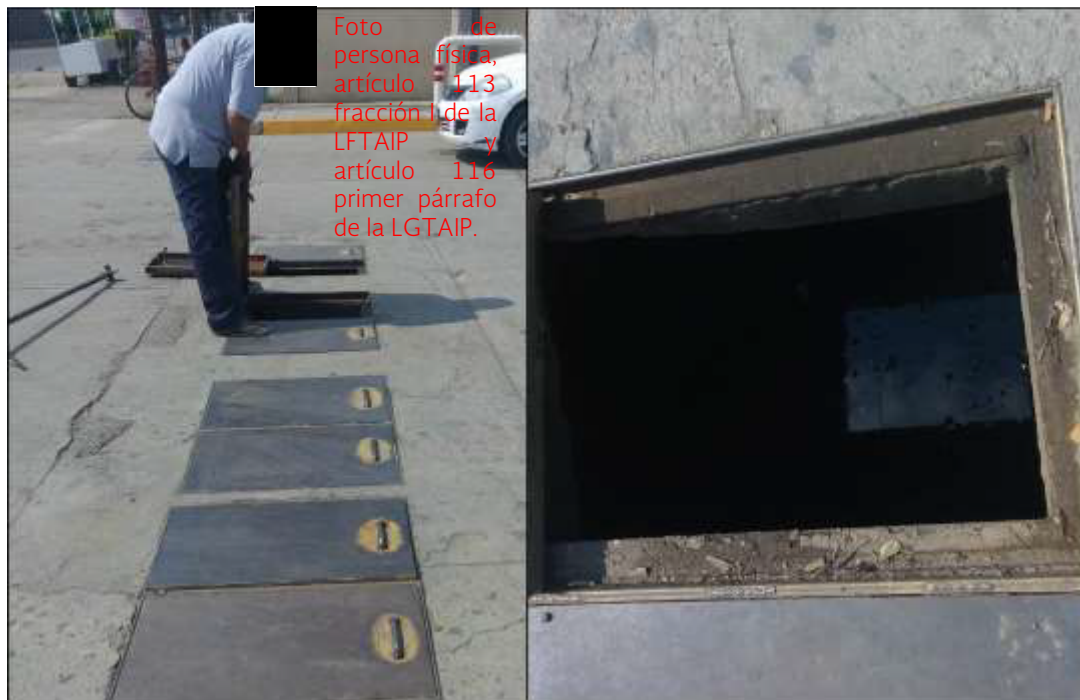
Fotografía 10. Trampa de grasas y aguas con residuos de hidrocarburos.
