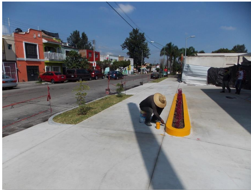
Figura 23. Imagen de algunas de las áreas verdes con que contará la gasolinera.
