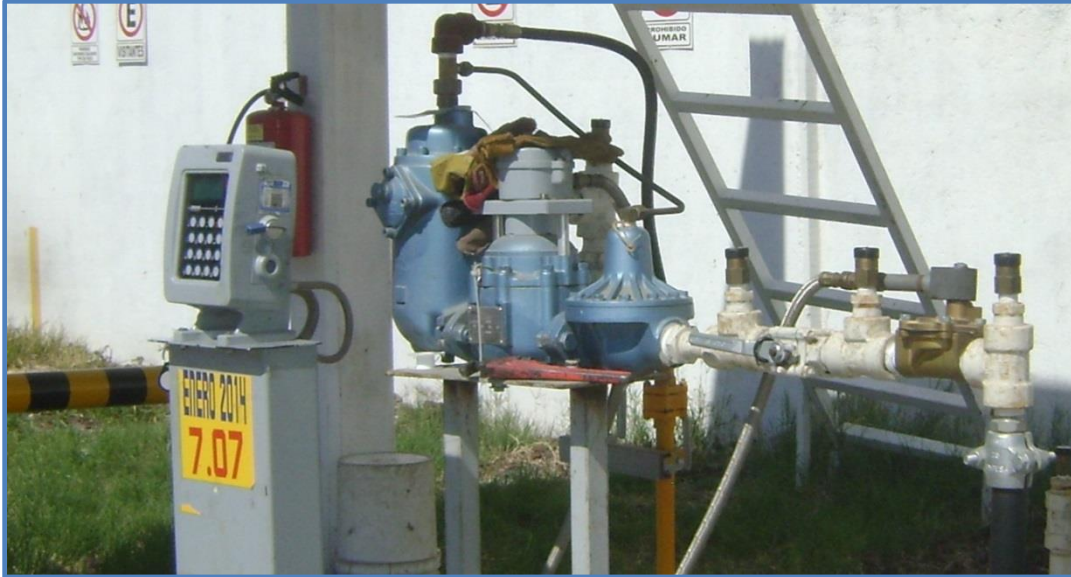
Figura III.1.c)-1. Dispensario doble para el Gas L.P.
