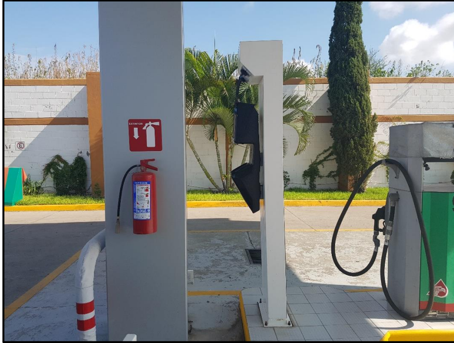
Fotografía 5. Extintor en zona de dispensarios.
