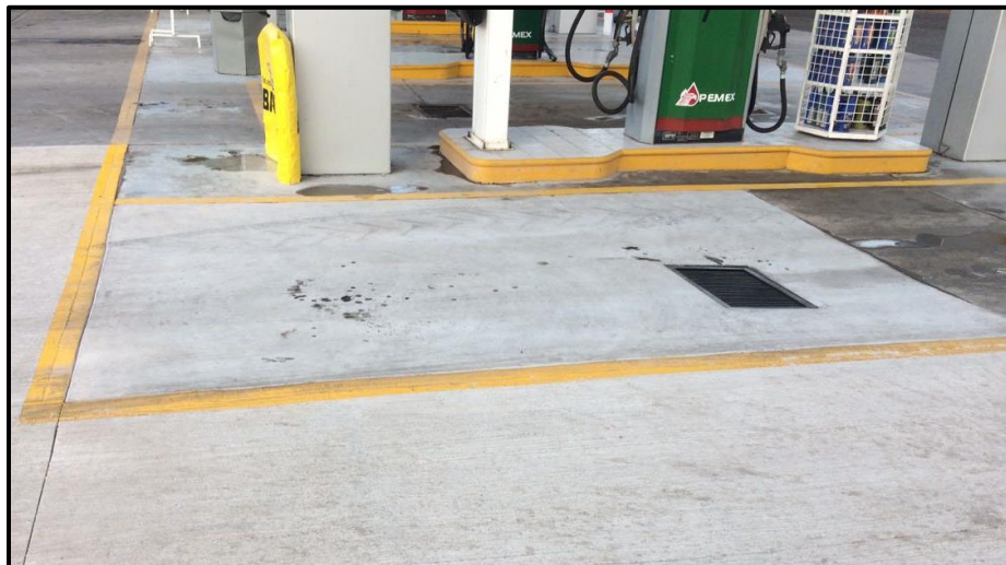
Fotografía 8. Rejilla de aguas aceitosas en zona de despacho de combustible.
