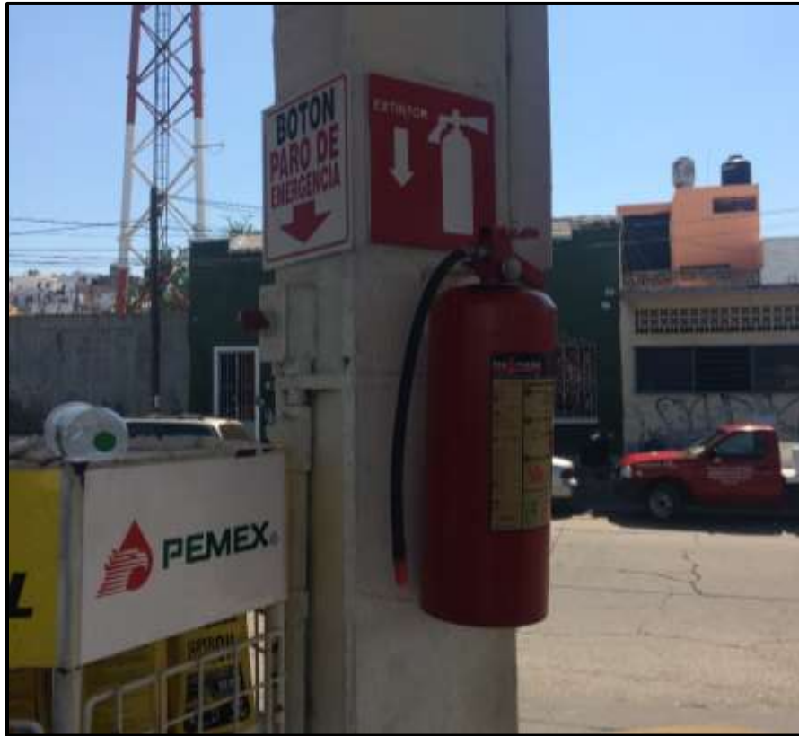
Fotografía 6. Botón de Paro de emergencia y extintor.
