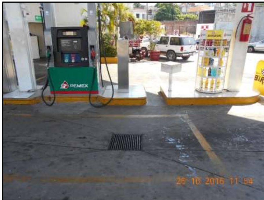
Fotografía 5. Extintor en el área de despacho de combustible.
