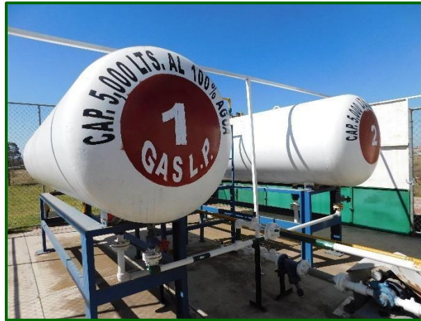
Imagen 5. Tanques de almacenamiento de Gas
