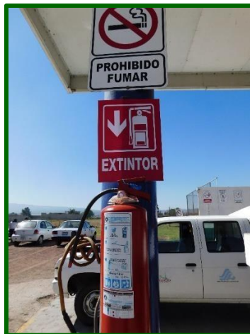
Imagen 7. Equipo contra incendio
