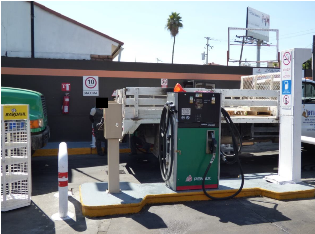
Fotografía 2. Estación en funcionamiento.
