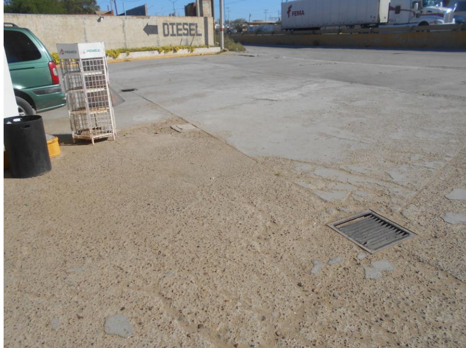
Figura 9. Rejilla del drenaje aceitoso.
