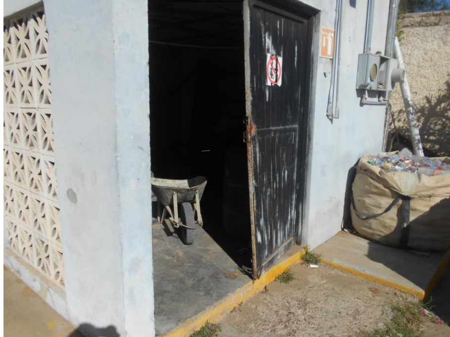
Figura 7. Cuarto de máquinas.
