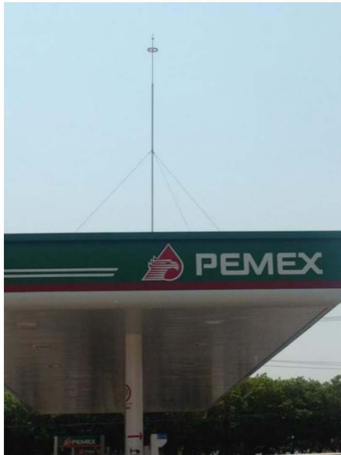
Figura 6. Pararrayos instalado en la estación de servicio
