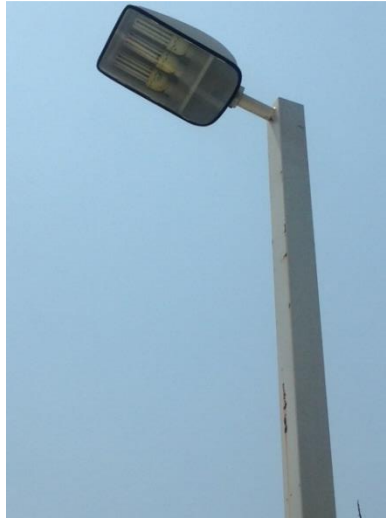
Figura 7. Alumbrado exterior Luminaria tipo Led.
