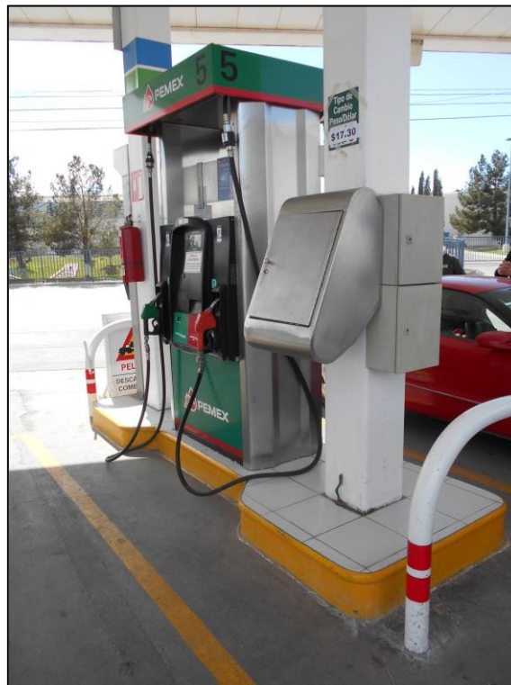
Figura 2. Área de despacho de la estación de servicio.
