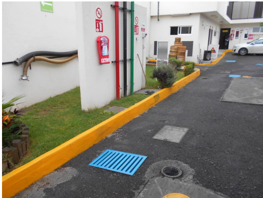
Figura 4. Se aprecia el sistema de venteo normal de los tanques de almacenamiento, rejillas de drenaje pluvial, mangueras utilizadas para realizar la conexión para el proceso de descarga de petrolíferos, áreas verdes del proyecto y pozos de observación.
