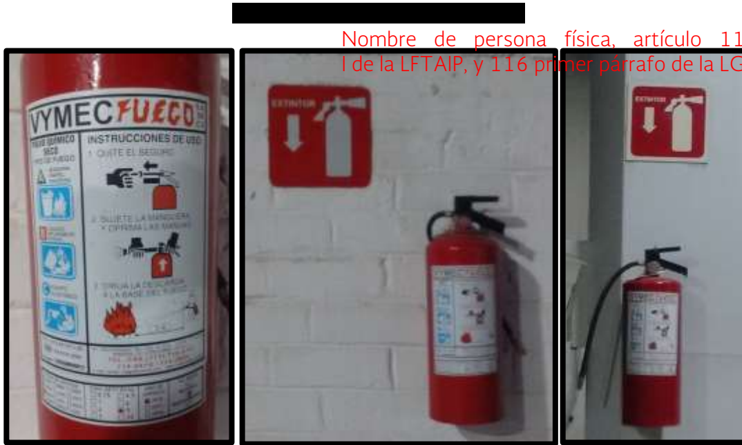
Figura 13 Extintores ubicados en la Estación de Servicio
