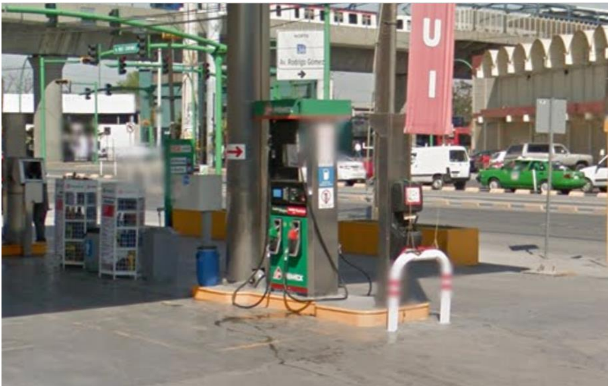
Figura 2. Dispensarios de la estación de servicio.
